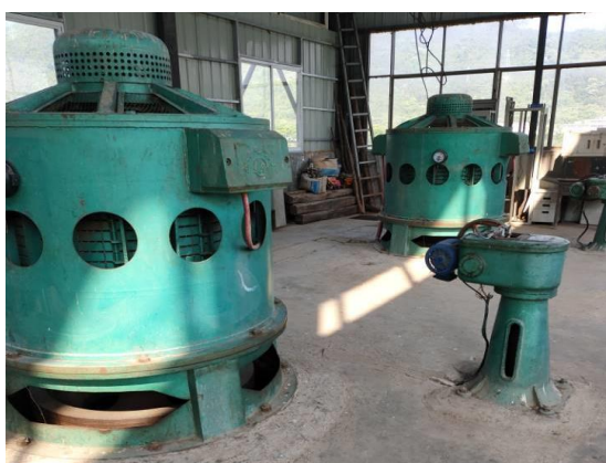
图11 厂房内部机组
