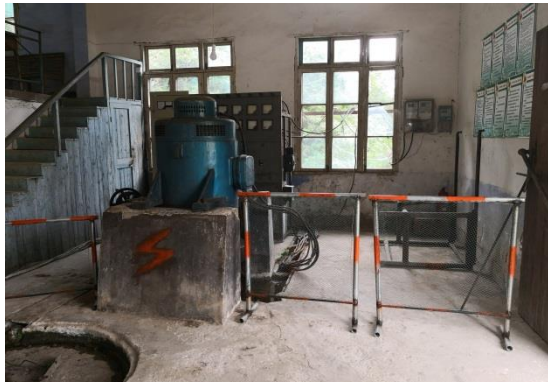
图 10 厂房内部机组
