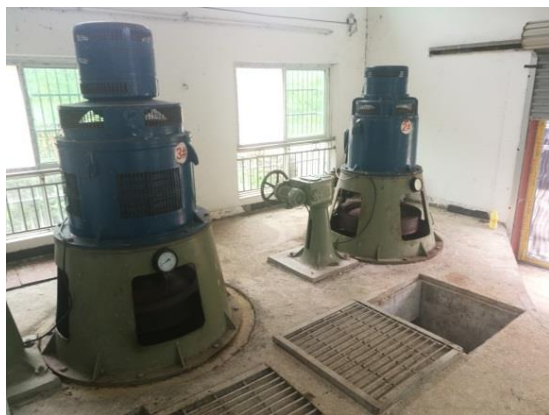
图 12 厂房内部机组
