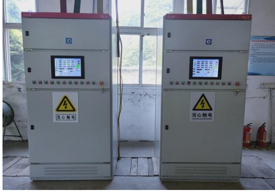
图 12 厂房内部机组
