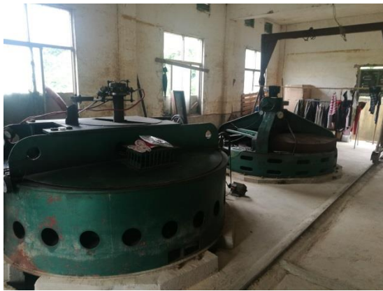
图 11 厂房内部机组
