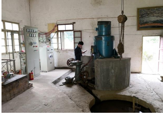
图 11 厂房内部机组
