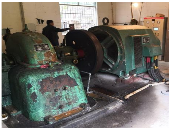
图 10 厂房内部机组
