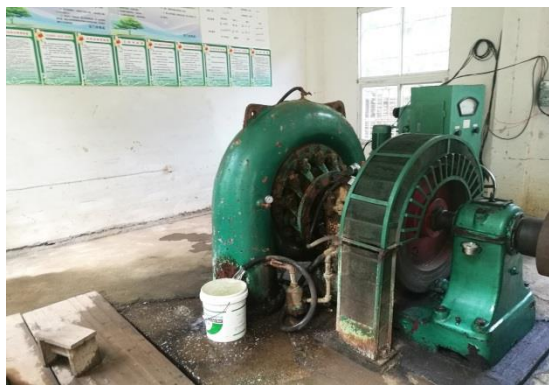
图 11 厂房内部机组
