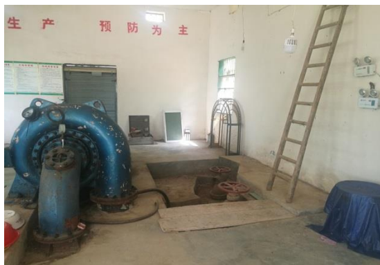
图 11 厂房内部机组
