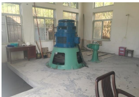
图 11 厂房内部机组
