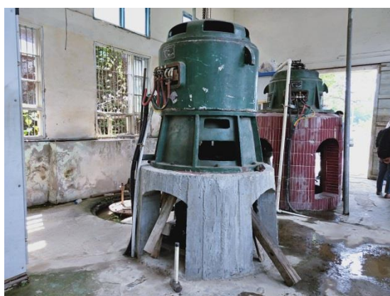
图 10 厂房内部机组
