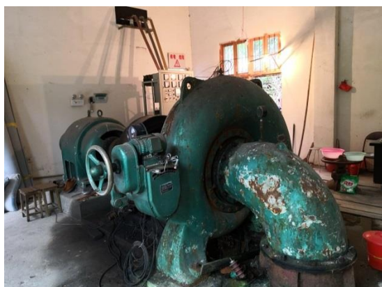
图 11 厂房内部机组
