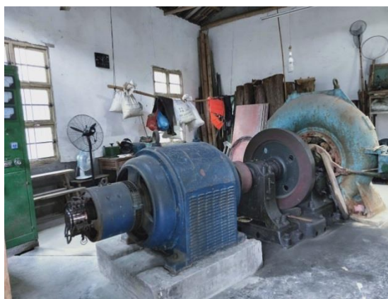
图 11 厂房内部机组
