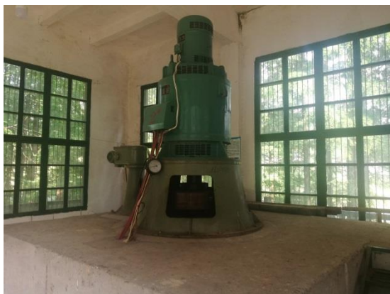
图 9 厂房内部机组
