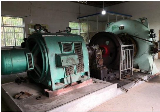
图 11 厂房内部机组
