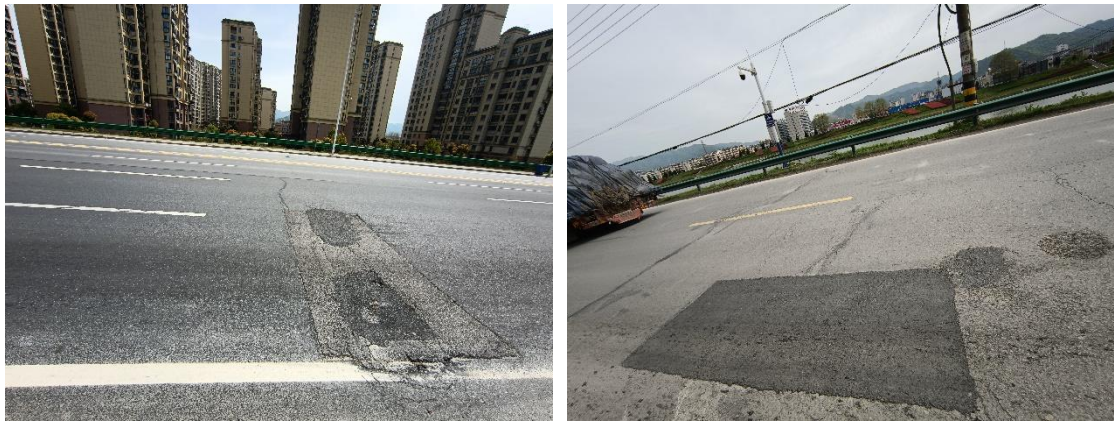
图 2.2-1 现有道路路面（路面损坏）
