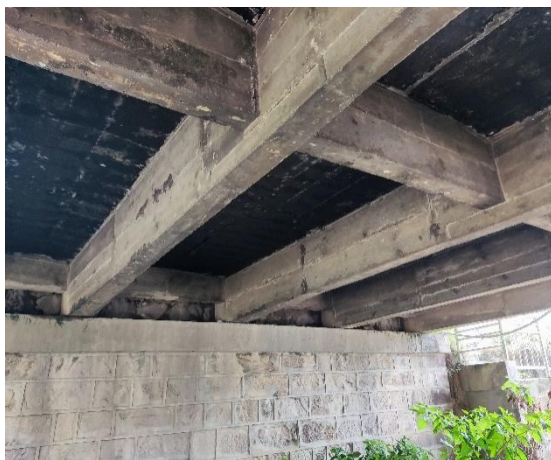
梁板、肋出现裂缝
