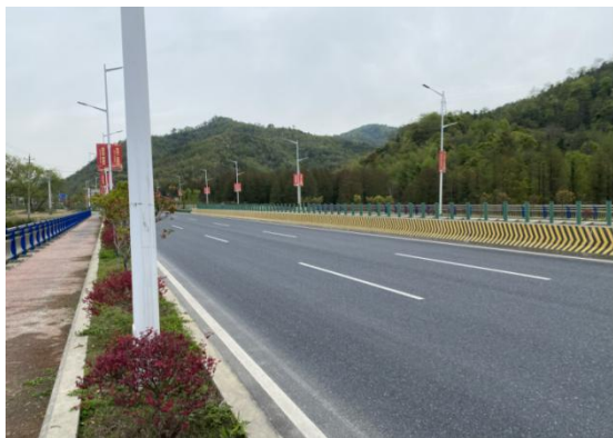
侧分带未安装防撞栏
